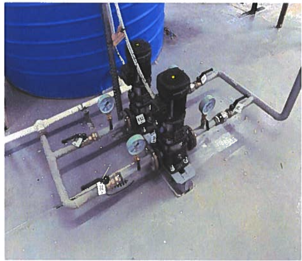
Блок насосов подачи дизельного топлива
