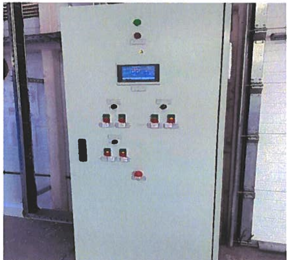
Щит автоматики котельной
