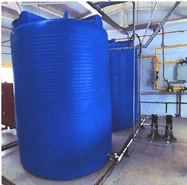
Баки резервного (дизельного) топлива
